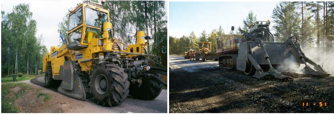
Bild 10-7 Inblandning (homogenisering) av beläggning i obundet bärlagergrus. Fräsdjupet var i den vänstra bilden 20 cm och i den högra bilden 40 cm. I fallet till vänster inblandades sedan 2,5 % emulsion.
