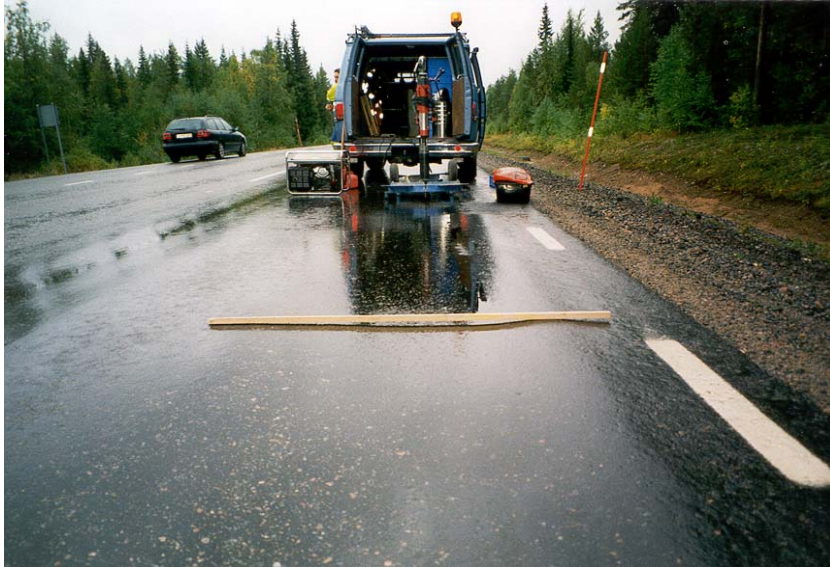
Bild 8-15 Deformationer uppkomna under första sommaren.
