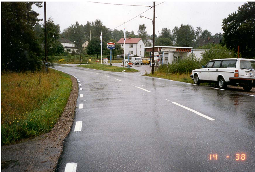
Bild 8-16 Vågbildning (korrugering) på grund av massans tröghet vid utläggning.
