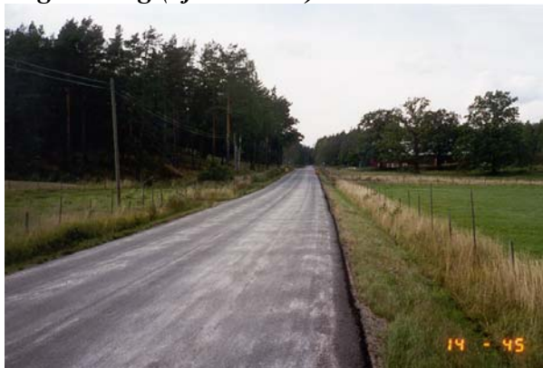
Bild 7-17 Exempel på skador som kan uppkomma på kalla återvinningsbeläggningar.
