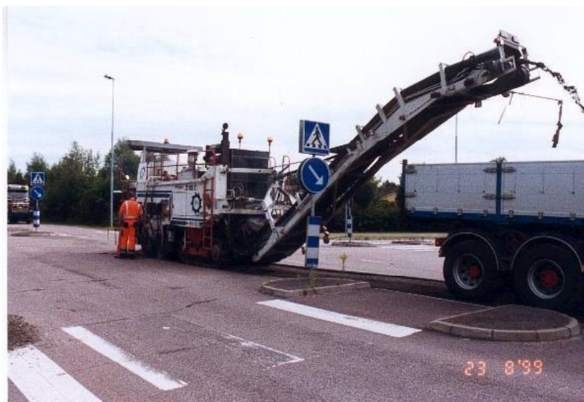
Bild 3-1 Lådfräsning före förstärkningsåtgärd.
